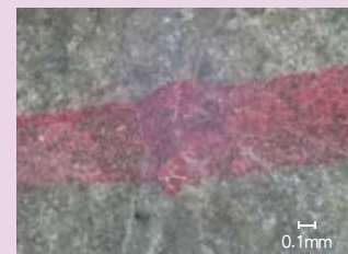
⑥ 水分供給後に、ひび割れが閉塞した状態
