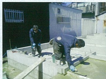
2014年バージョン空調服を試着して基礎工事をしている様子 愛知県名古屋市:Nさん施行現場
